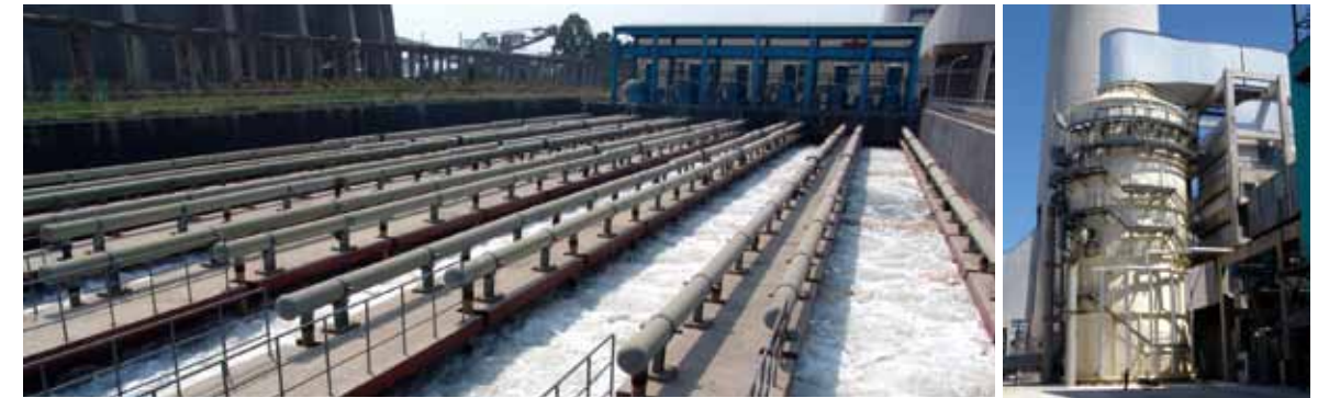
图为厦门华夏国际电力发展有限公司电厂烟气脱硫装置—曝气池和脱硫塔
