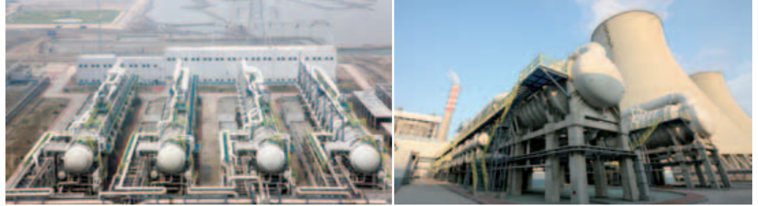
国投北疆电厂利用发电余热进行海水淡化，相对于常规发电机组可提高 10% 左右的全厂热效率，已投产日产淡化水量 10 万吨。
