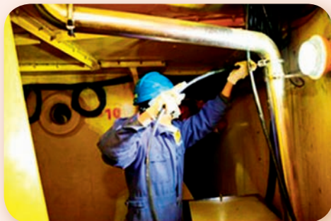
锦屏水电站电力生产照常进行
